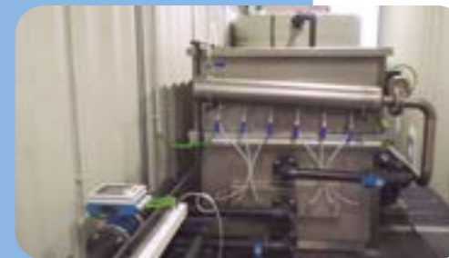
DAF en contenedor
