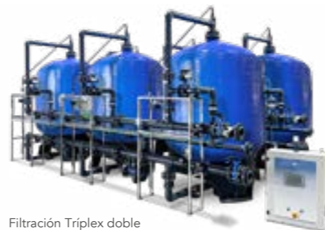
Filtración Tríplex doble
